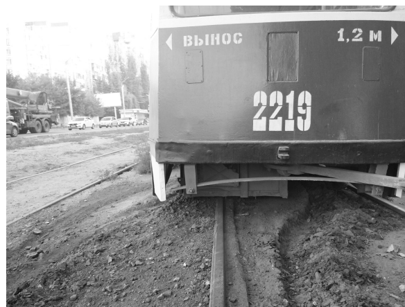
Рис. 3. Открытые незадернованные колеи трамвайных путей (фото А. М. Неврюева)
