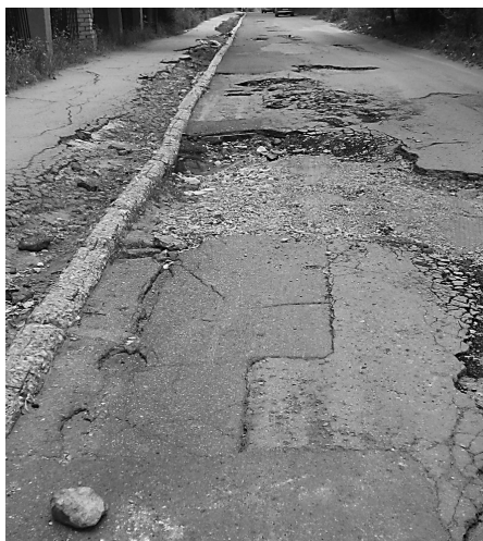
Рис. 1. Временные водотоки разбивают асфальтовое покрытие дороги, образуя на ней небольшие эрозионные формы – канавы, бороздки, рытвины. Район 2-й Дачной. Фотография И.А. Яшкова, 2006 г.
